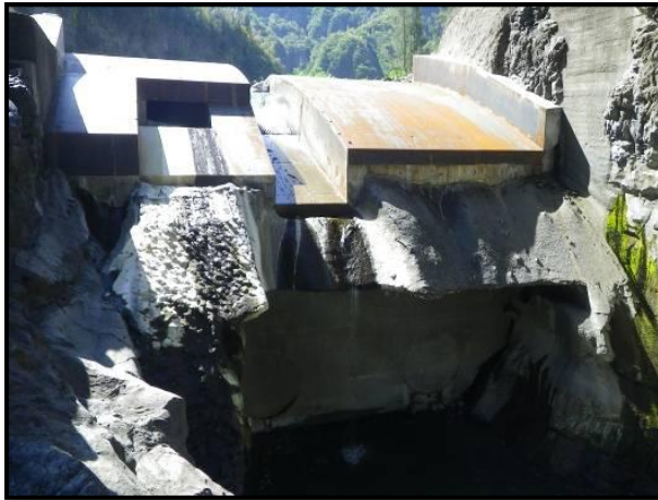
Figure 13 : Captage du Grand Bras de Cilaos
