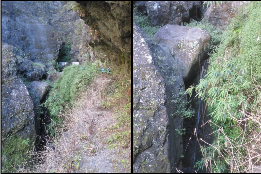
Figure 24 : Vues du captage Bras de la Vierge et du cassé en aval immédiat.
