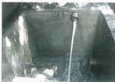
Bâche collectrice générale (absence de crépine sur le départ)
