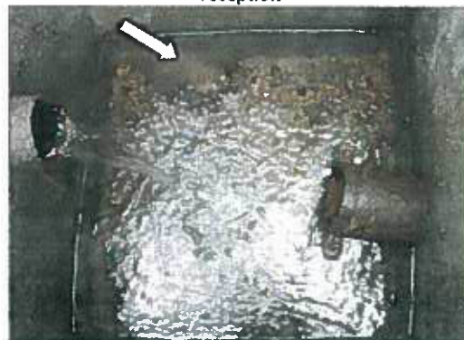
Vues des conduites d'arrivée et de départ dans l'ouvrage de réception (il manque une crépine sur le départ de l'ouvrage)
