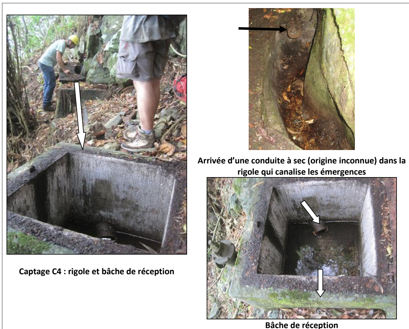
Figure 15 : Photographie du captage C4 et de l'ouvrage de réception associé
