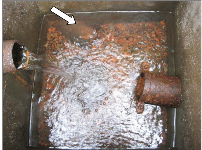
Vues des conduites d'arrivée et de départ dans l'ouvrage de réception
