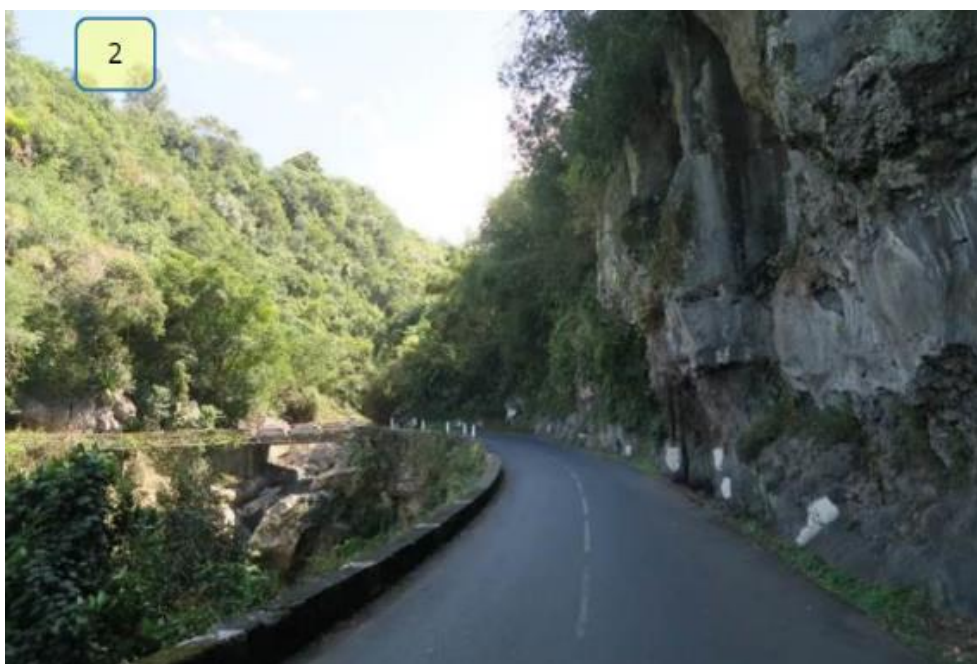
Figure 26 : Falaise avec risque d'éboulement au niveau de la tranchée à réaliser
