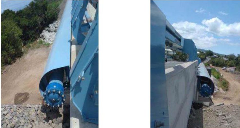
Figure 38 : Ouvrage d'art de la Ravine Blanche avec conduite DN500 mm en attente pour le projet PISUD
