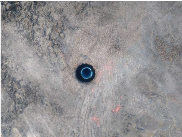
Photo 32 : Vue rapprochée Pz2 (Ouvrage temporaire non finalisé – margelle, capot – rebouché en fin de chantier)
