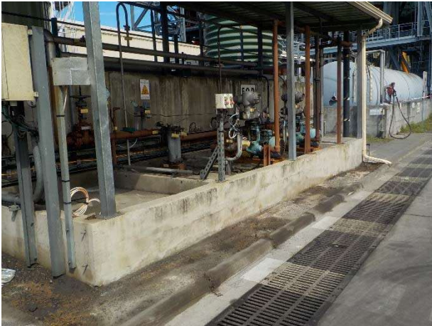
Photo 7 : Zone de dépotage de la cuve semi-enterrée de gasoil non routier
