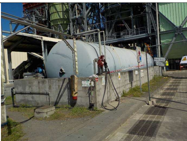
Photo 5 : Cuve aérienne de gasoil non routier
