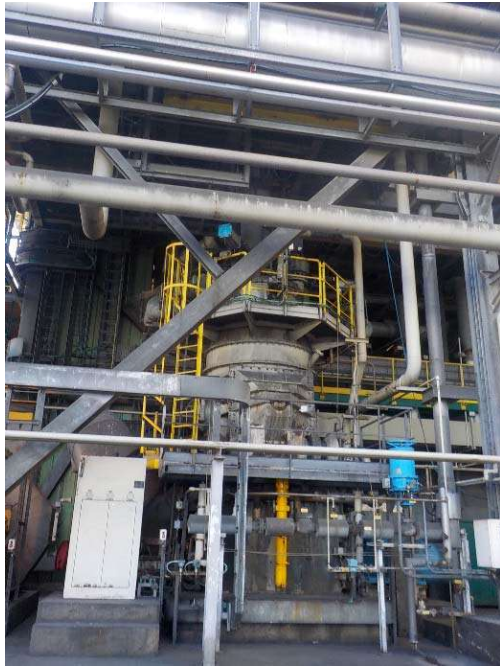
Photo 1 : Installation de combustion
