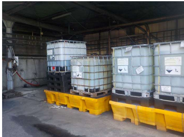
Photo 8 : Stockage de produits de traitement des eaux
