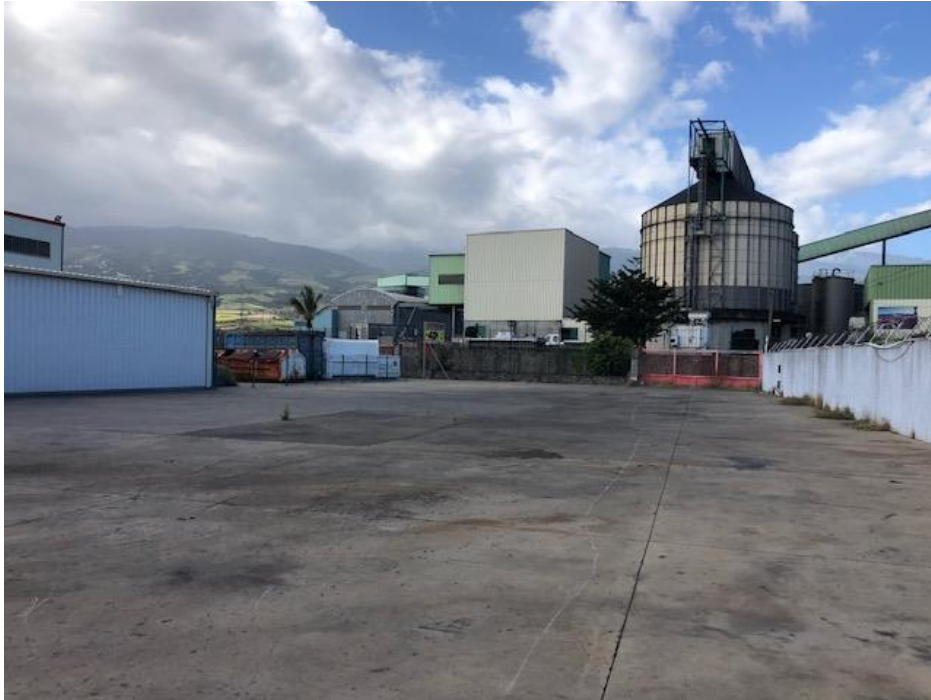
6 : Dallage plus usé et ponctuellement abimé en partie Ouest du site
