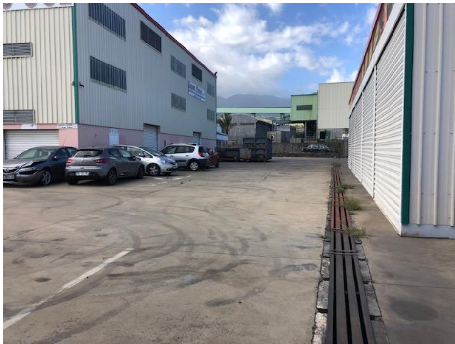
5 : Dallage en bon état en partie Est du site et caniveau de récupération des EP
