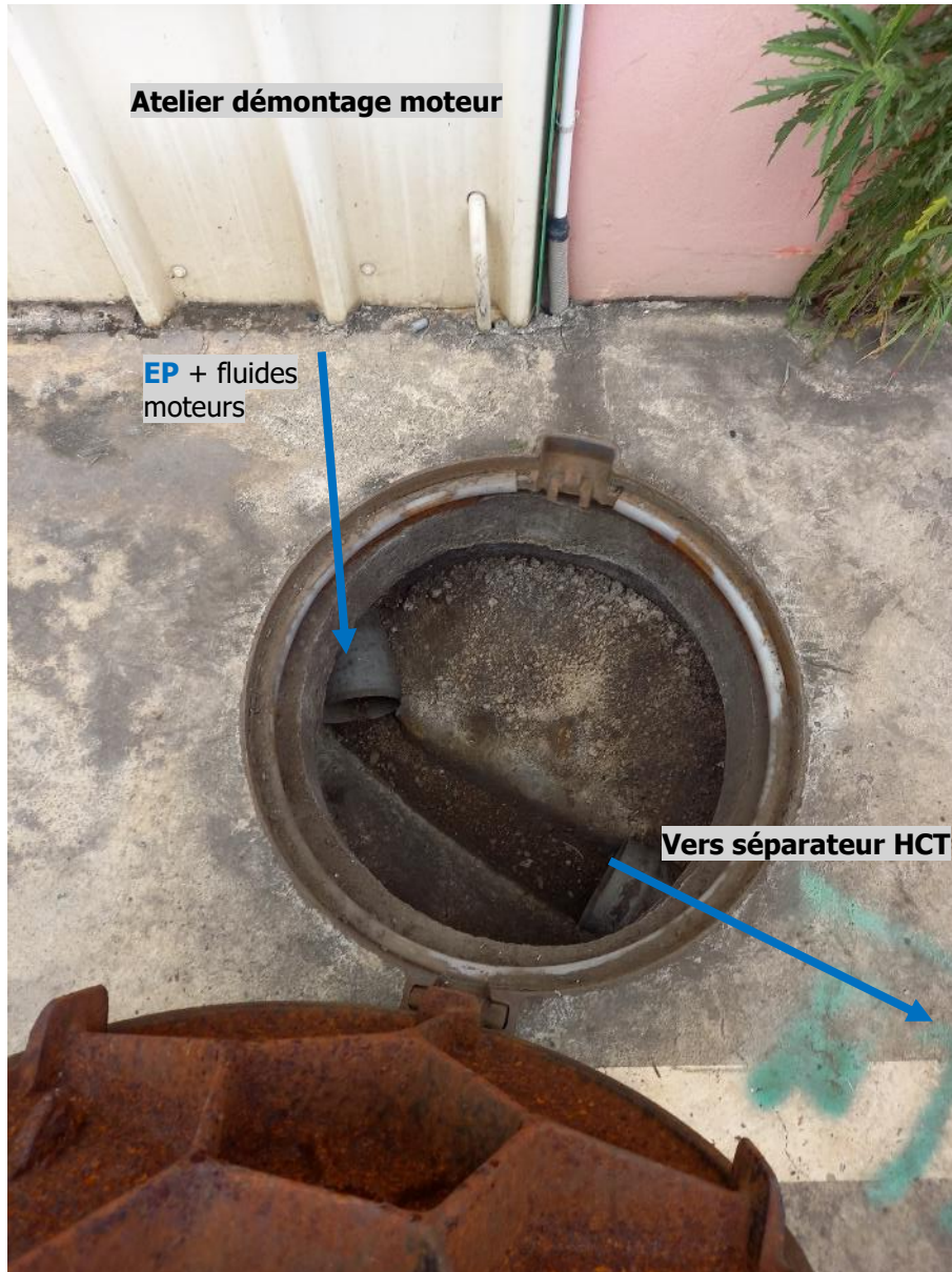
3 : Arrivée du réseau de récupération des EP depuis l'atelier vers le séparateur
