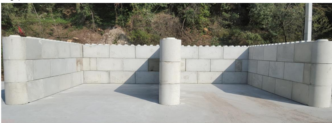
Figure 21: Illustration des parois type Big bloc pour la délimitation de la zone de stockage à l'air libre des ferrailles broyées
