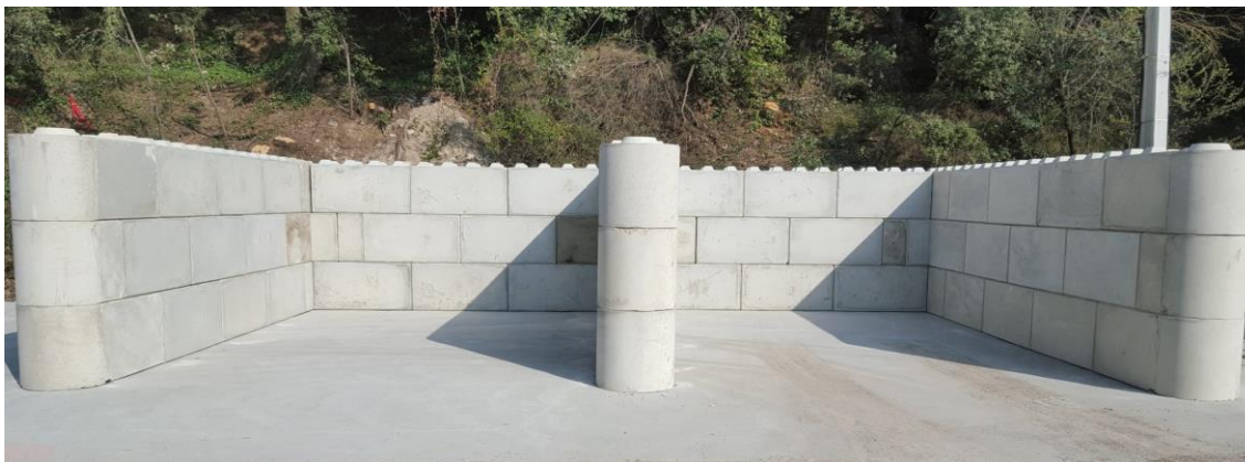
Figure 81: Illustration des parois type Big bloc pour la délimitation de la zone de stockage à l'air libre des ferrailles broyées
