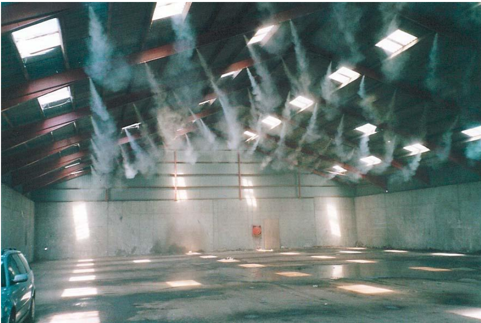
Photo du haut: Humidification pour suppression de la poussière dans des hangars de stockage.
