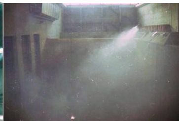
Canon de brumisation en ordures ménagères
