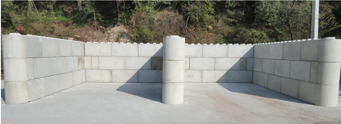
Figure 13: Illustration des parois type Big bloc pour la délimitation de la zone de stockage à l'air libre des ferrailles broyées
