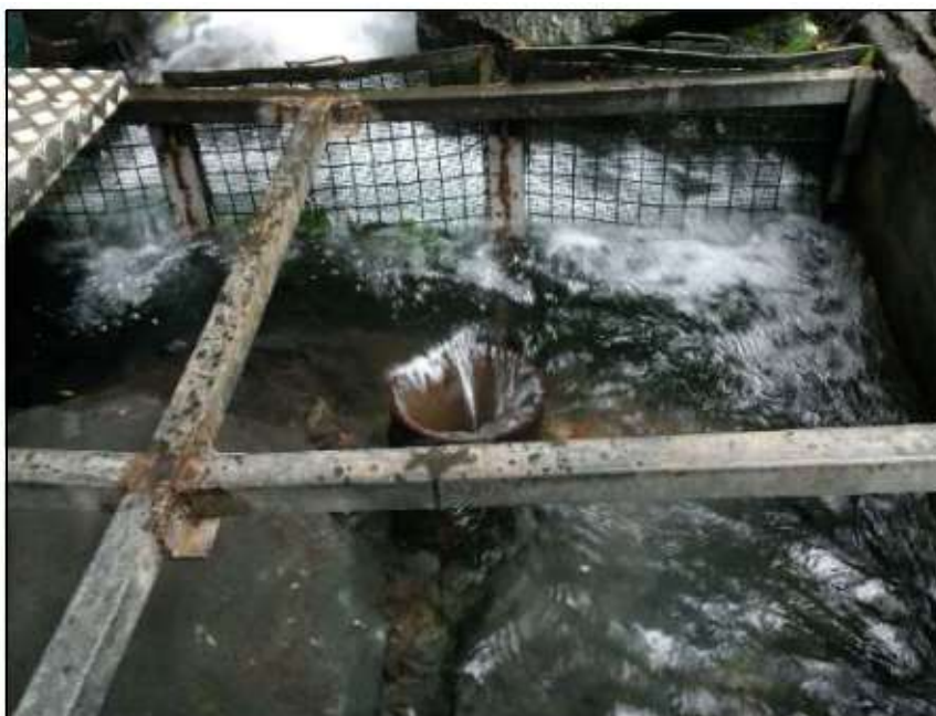
Grille de filtration à l'avant et conduite de trop plein
