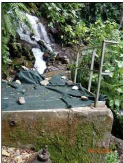
Bâche de collecte des eaux avec garde-corps et canal de dérivation en amont – Suivi et entretenu par Sudeau
