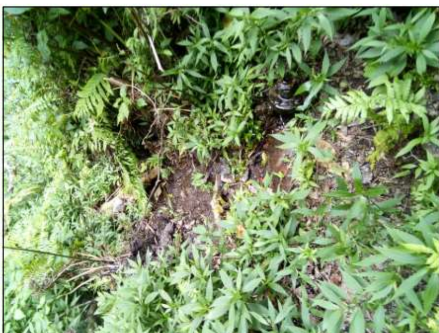
Tête de la conduite d'adduction Ø 250 mm en aval de la bêche de collecte des eaux
