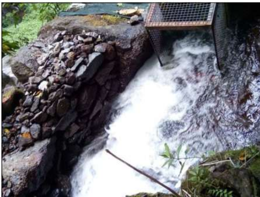
Canal de dérivation aménagé dans les blocs éboulés et cage de filtration des gros débris en amont du captage
