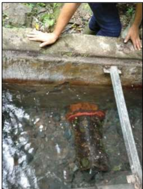
Vue de la crépine de la prise d'eau dans le bassin
