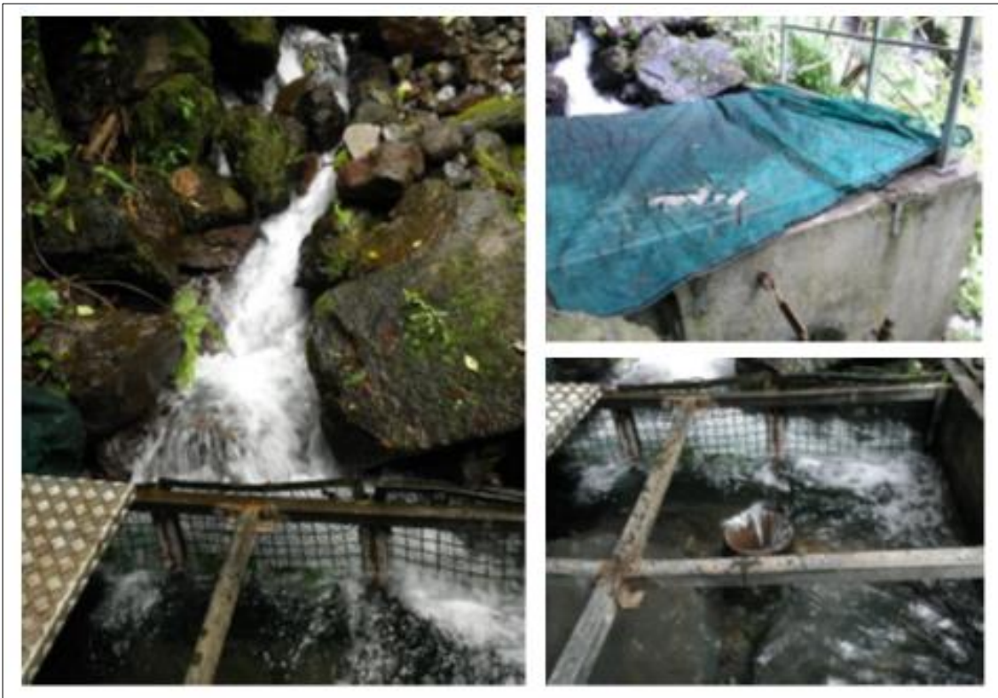
Photographie 2 : La prise du captage Cazala en 2017 (Clichés EECOI 2017)
