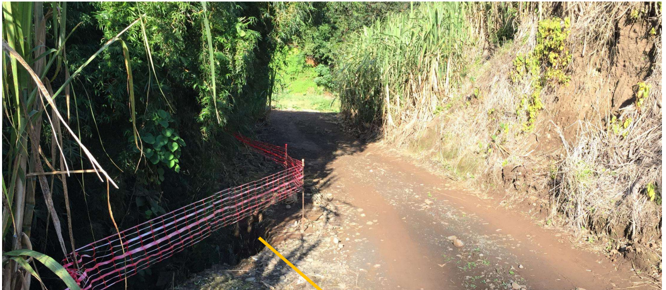
Photo 2 Glissement de terrain sur le tracé actuel
